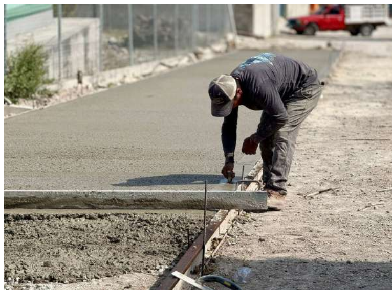
En el Encino se dio el banderazo de inicio a la Construcción de Pavimentación Hidráulica en la calle de acceso al Centro de Salud, Con una inversión del FAISM 2025
